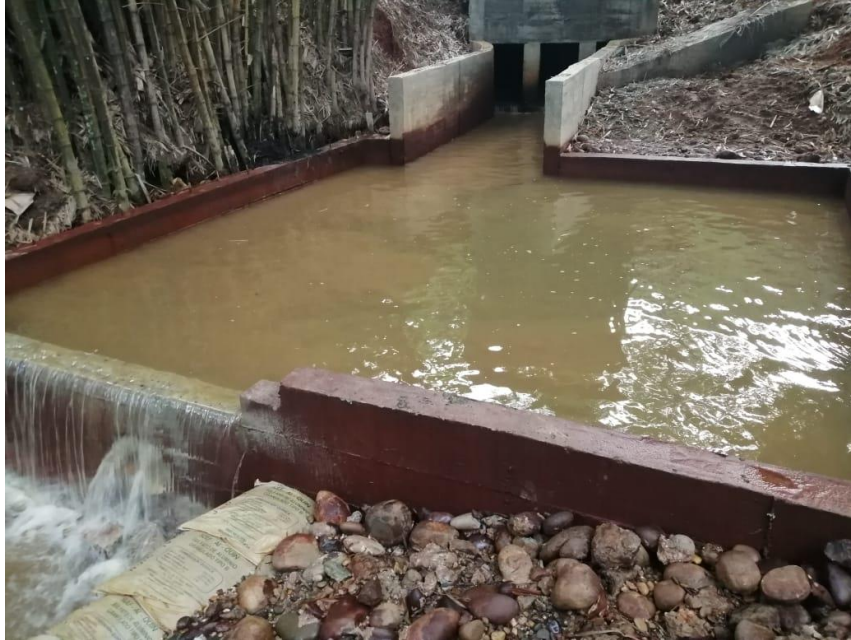
Imagen 07 Estructura principal de 36 m2 para recolección de sedimentos y arenas
